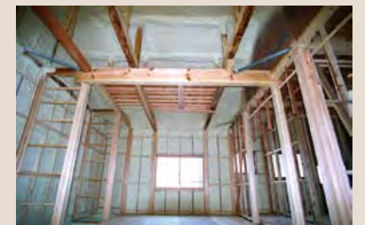
外壁から屋根の野地板にかけて、その裏側に断熱材が隙間なく吹付けられ、建物全体が断熱材によってすっぽり覆われています。
